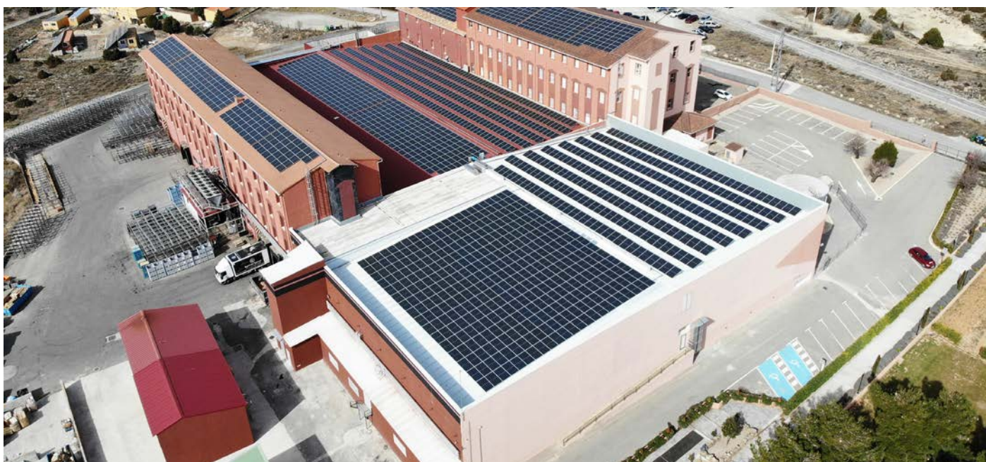
Placas fotovoltaicas instaladas en el secadero de Valsano Airesano de La Puebla de Valverde
